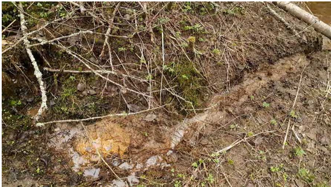
Kuva 26. Lähde 138-3 purkautuu kaivon renkaan ulkopuolelle vielä tihkupintana.
